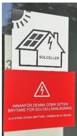
Figur 4 Syltning utanför entré där manöverdon till DC-brytare är placerad
